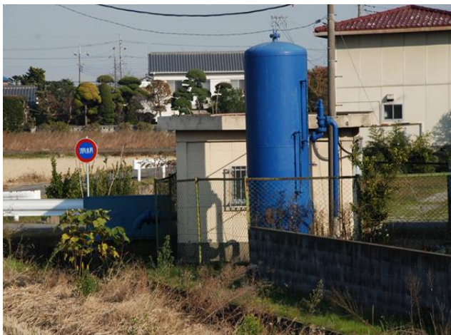
加圧ポンプ付の配水設備
