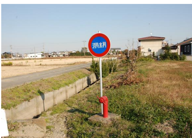
用水と消火栓
